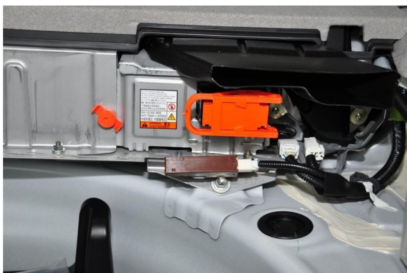
Servicestecker im Fahrzeug
